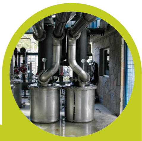
Élimination vapeur d'eau
