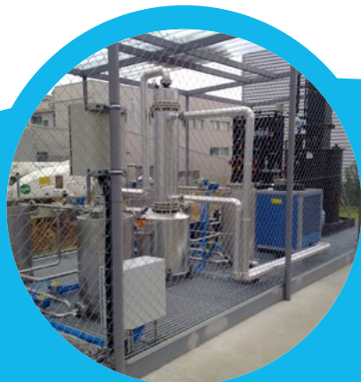
Vue de la récupération d'énergie.
