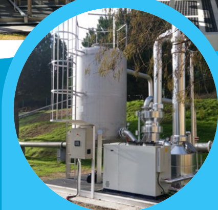
Station de nettoyage du Biogaz pour WWTP
