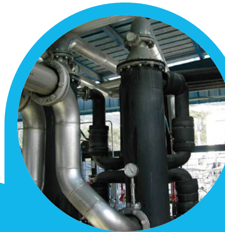
Séchage de Biogaz
