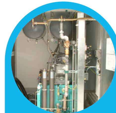
compresseur de biogaz
