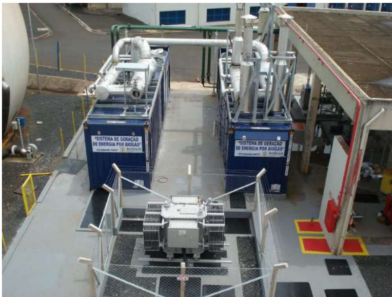
Figura 7. Módulos de cogeneración a partir del biogás.
