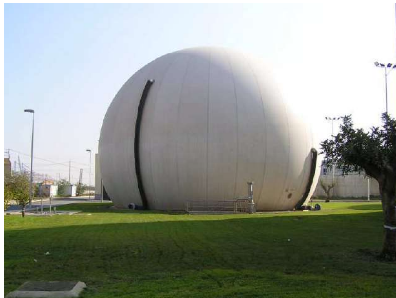
Figura 4. Sistema de almacenamiento del biogás. Gasómetro de de baja presión de doble membrana
